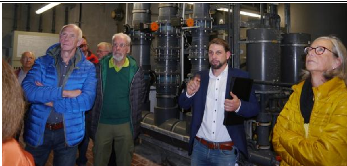
Bad Waldliesborn am Donnerstag, 29. September 2022 (II): Marc Hentschke (zweiter von rechts) brachte der SPD-Besuchergruppe viele Einzelheiten für den enormen Betriebsaufwand der Wasserflächen für das Gesundheitszentrum im Keller des Therme-Komplexes näher.
